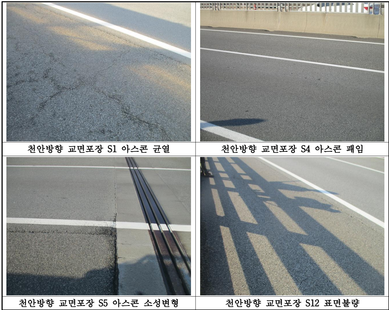
【사진 3.19】 교면포장 손상현황
