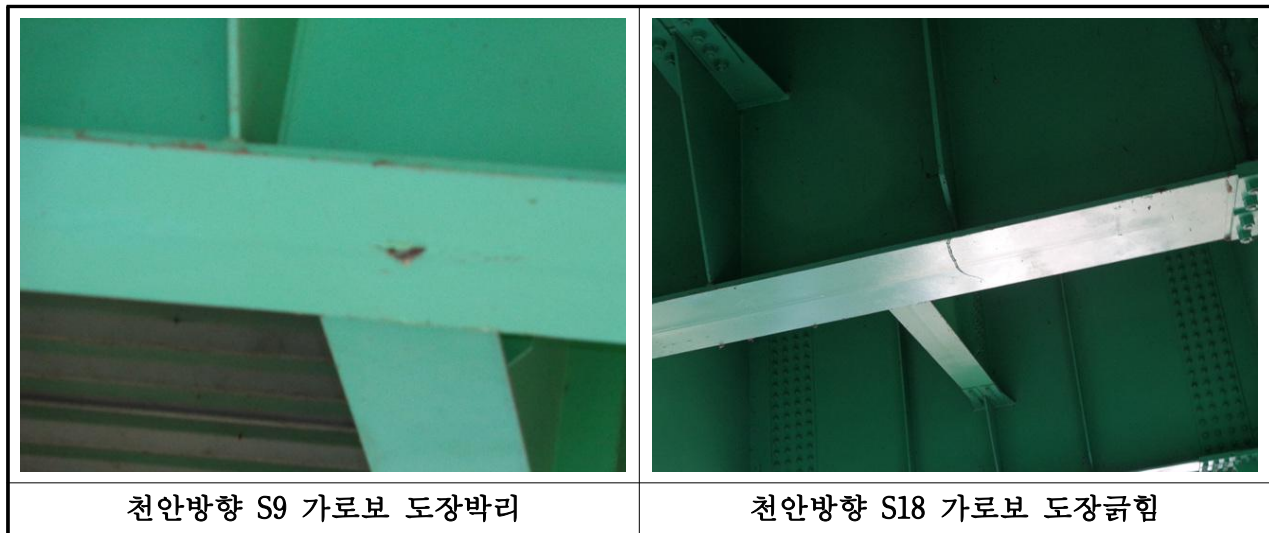
【사진 3.8】 가로보 및 세로보 손상현황
