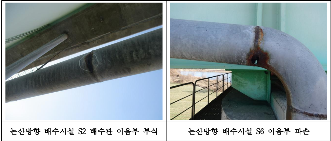
【사진 3.43】 배수관 손상현황
