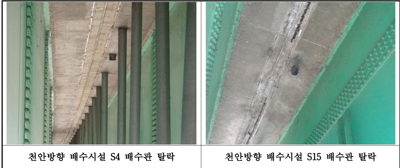
【사진 3.21】 배수관 손상현황
